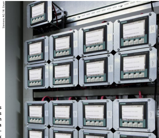
Zur Messung des Stromverbrauchs der Maschinen nutzt Fraisa Sentron PAC – insgesamt 24 Stück
