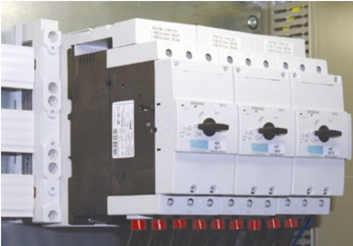
Die Absicherung gegen Überlast und Kurzschluss der einzelnen Kompaktabzweig-Batterien übernehmen Leistungsschalter Sirius 3RV.
