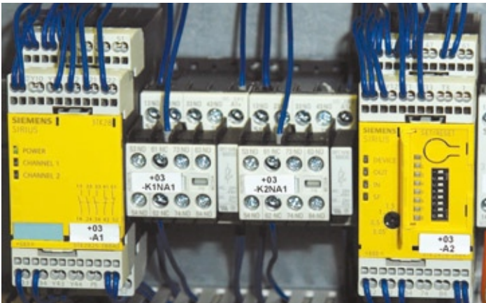
Das Sicherheitsschaltgerät Sirius 3TK2826 lässt sich über DIP-Schalter individuell den Anforderungen anpassen. Bilder: Siemens
