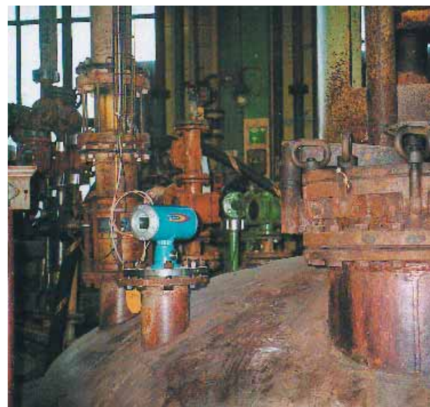
Die DyStar Textilfarben GmbH & Co. in Leverkusen setzt das SITRANS LR 300 zur zuverlässigen Füllstandmessung von Farbstoffen ein.
