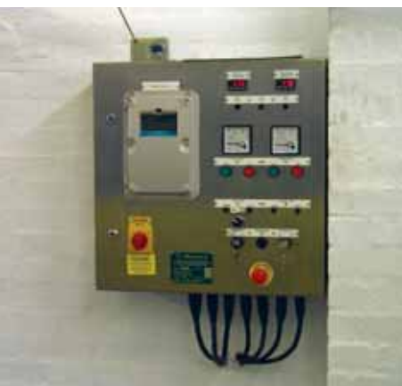
Der Füllstandsmesser überträgt das Signal an diesen Siemens MultiRanger 200 Ultraschall-Messumformer, der den Füllstand kontinuierlich anzeigt und Min. Füllstandalarme auslöst.
