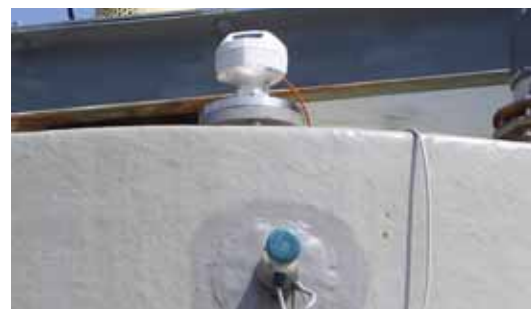
Ein oben auf dem Tank montierter SITRANS LR 200 Radar-Messumformer misst den kontinuierlichen Füllstand, während ein Pointek CLS 100 kapazitiver Schalter eine Max. Füllstand-Ausfallsicherung bietet. Beide Geräte werden außen an der Tankwand angebaud.
