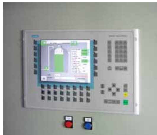
Die Siemens HMI liefert den Zustand jedes Tanks mit optischer Füllstandanzeige.
