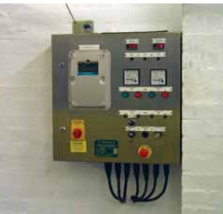
Le transmetteur de niveau envoie un signal au transmetteur ultrasonique Siemens MultiRanger 200, qui affiche la mesure de niveau en continu et commande les alarmes de niveau bas.
