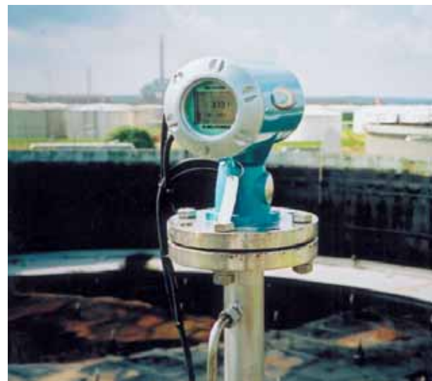
L'installation de guides d'ondes avec des instruments IQ Radar a résolu un délicat problème de mesure pour BP Lubricants à Hambourg, sans nécessiter de modifications coûteuses des cuves ou des brides existantes.
