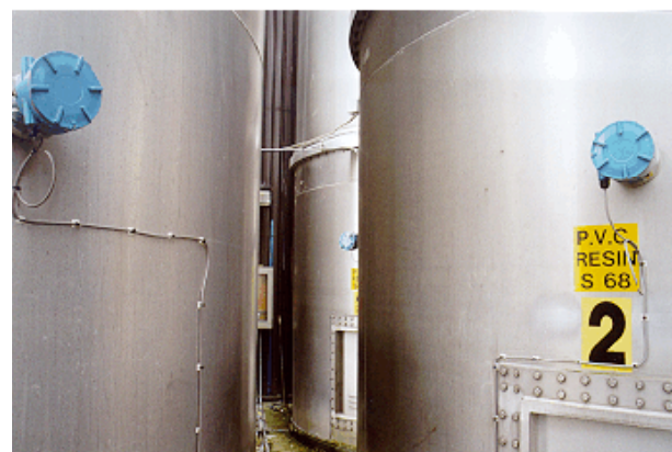
Le Mercap de Milltronics mesure les niveaux de poudre de PVC pulvérulent afin de maximiser la rentabilité chez Anglian Windows.
