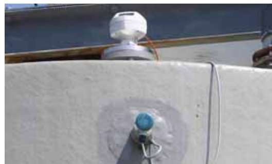
Un transmetteur radar SITRANS LR 200, installé en haut de la cuve fournit une mesure de niveau en continu tandis qu'un contacteur capacitif assure une sécurité de niveau haut. Les deux types d'instruments sont installés à l'extérieur de la cuve.
