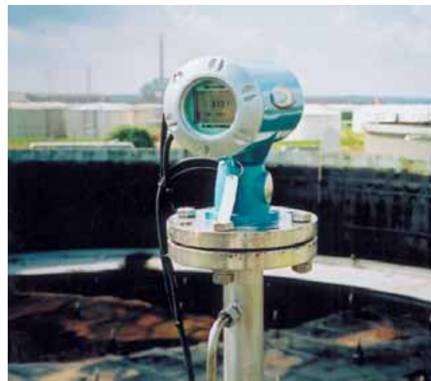
La instalación de guías de onda con instrumentos IQ Radar solucionó un difícil problema de medición para BP Lubricants en Hamburgo, sin necesidad de modificaciones costosas en los tanques o bridas.
