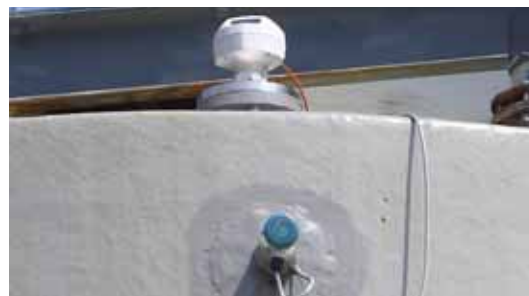
Un transmisor de nivel por radar Siemens SITRANS LR 200 colocado en la parte superior del tanque proporciona mediciones continuas de nivel, mientras que un conmutador de capacitancia Pointek CLS 100 actúa como protección segura contra desbordamientos.
