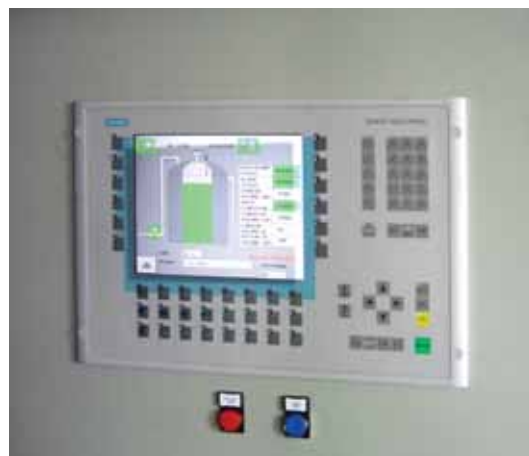
El HMI de Siemens indica el nivel de cada tanque mediante señales visuales.
