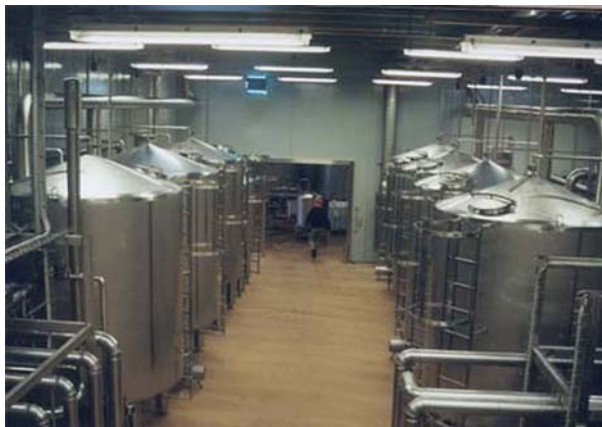
Tankanlagen mit CIP-Reinigung
