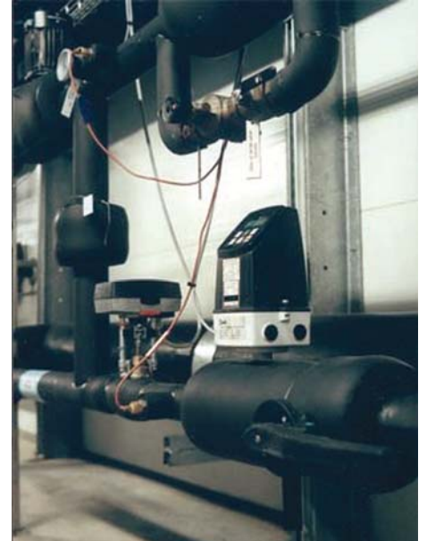
Der magnetisch-induktive Durchflussmesser SITRANS F M ist in der Wasserzuleitung eingebaut.
