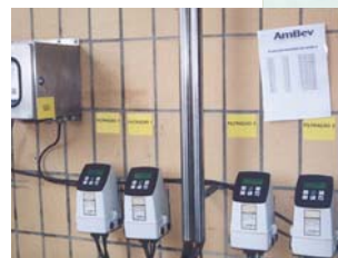
Detailansicht der Messumformer zur Auswertung der Signale der Durchfluss-Messaufnehmer. Zwei Geräte steuern die Dosierung des Antioxidationsmittels, während die anderen zwei die Zugabe von Schaumstabilisierer steuern.
