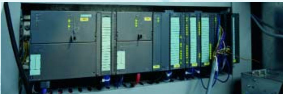
Schaltschrank mit S7-300 und technologischer 317-2DP-CPU sowie integrierter Motion-Control-Funktion.
