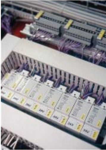
Eine der diversen EIB-Unterstationen, die auf den verschiedenen Stockwerken verteilt sind.
