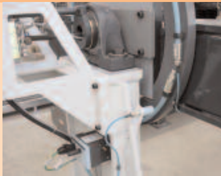
Der an der Drehvorrichtung installierte Leckwellenleiter sorgt für die definierte Ausbreitung der Funkwellen
