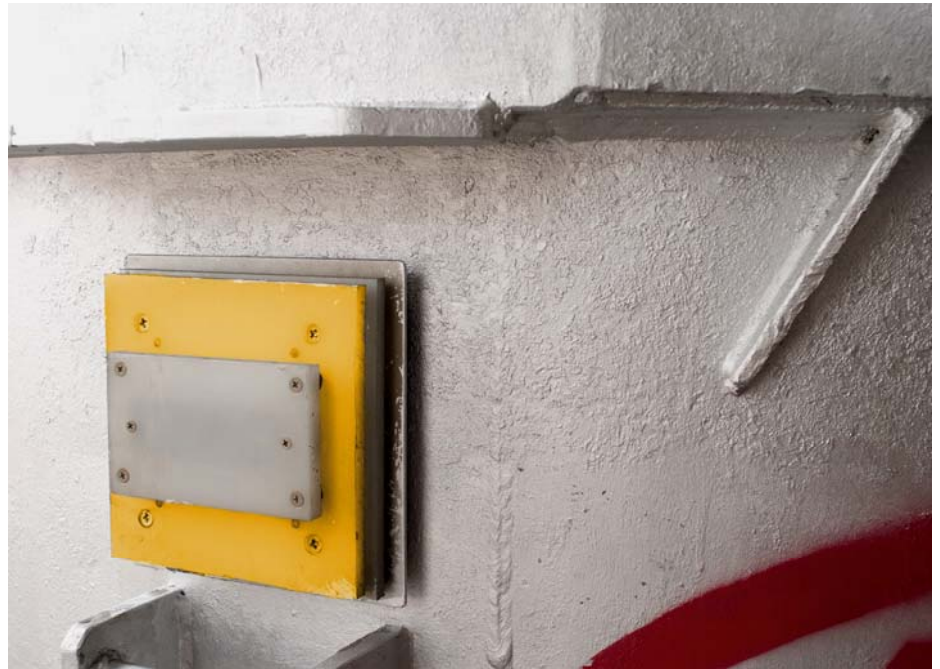
Die hohen Außentemperaturen werden durch eine mehrschichtige Konstruktion an die Umgebungsluft abgegeben, sodass der Transponder Simatic RF620T (unterhalb der weißen Abdeckplatte) innerhalb der Spezifikation betrieben wird.
