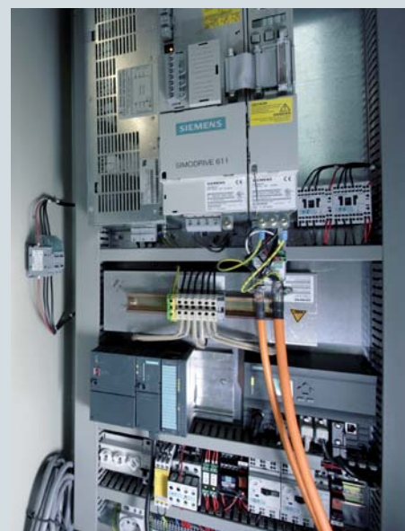
Neben der Sensorik stammt auch die übrige Steuerungs- sowie die Antriebstechnik von Siemens
