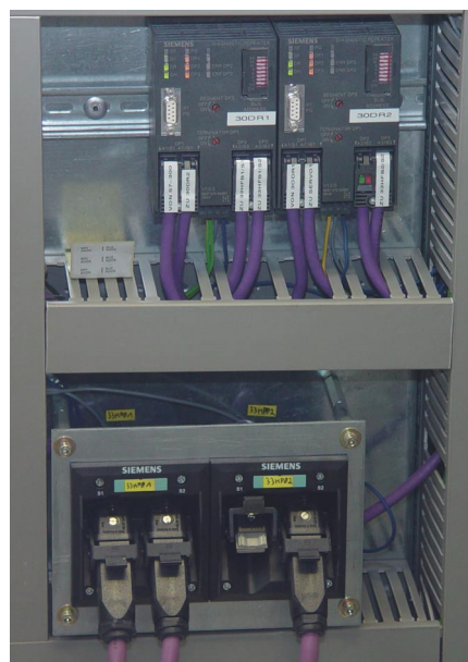
Bild 3. Vier Profibus-Stränge sind in der Anlage verlegt. Zur Signalverstärkung und für Diagnosezwecke, wie die Lokalisierung eines Kabelbruchs, sind zwei Diagnose-Repeater eingesetzt
