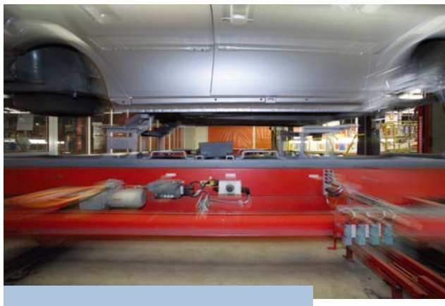
Bild 3: Geschwindigkeit, Abbremsen und Positionierung des Querförderers werden über induktive Näherungsschalter und bodenmontierte Signalrampen gesteuert (rechts). Die Ecofast-Motorstarter der Förderzeuge können dank Ausführung in Schutzart IP67 direkt an den Antriebsmotoren eingesetzt werden (links).
