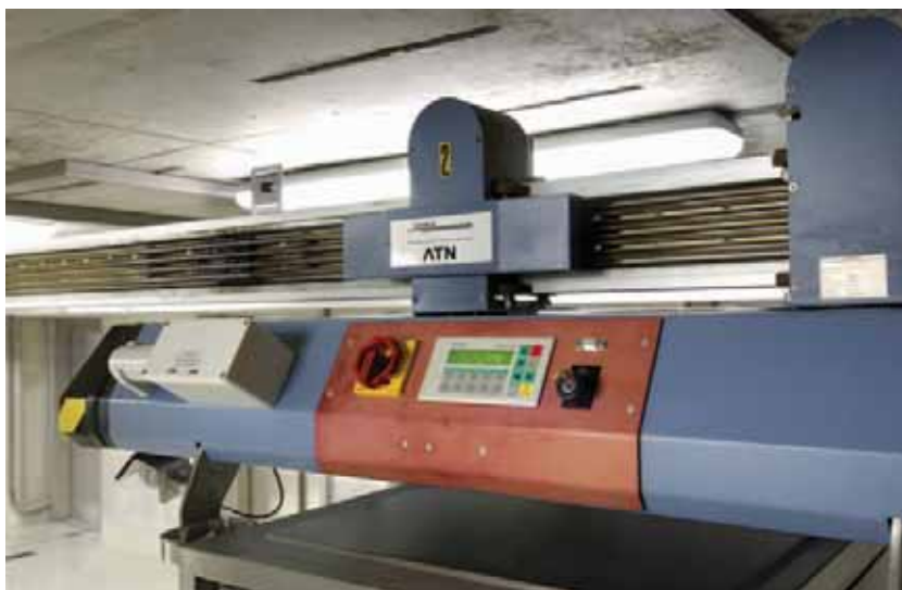
Das Simatic Operator Panel OP3 an den Fahrwerken ermöglicht einfaches Bedienen und visualisiert aktuelle Betriebsdaten.
