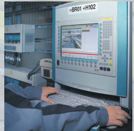
Bequeme und komfortable Anlagenübersicht mit WinCC auf einem Panel PC 670
