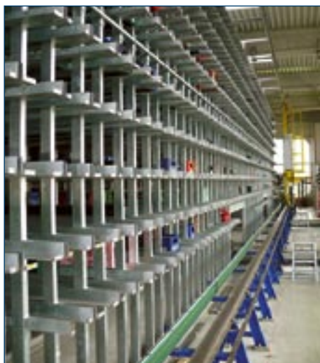
Bild 2: Auf einer Grundfläche von nur 6 x 33 m und 7,5 m Höhe können bis zu 15.000 Kisten Getränke gelagert werden. Je ein Regalbediengerät (RBG) an der Vorder- und Rückseite des Lagerregals sorgt für die Be- und Entladung. Vom fahrbaren RBG führt Profinet verschleißfrei über RCoax Leckwellenleiterkabel per 5-GHz-WLAN-Funktechnik zur stationären Steuerung
