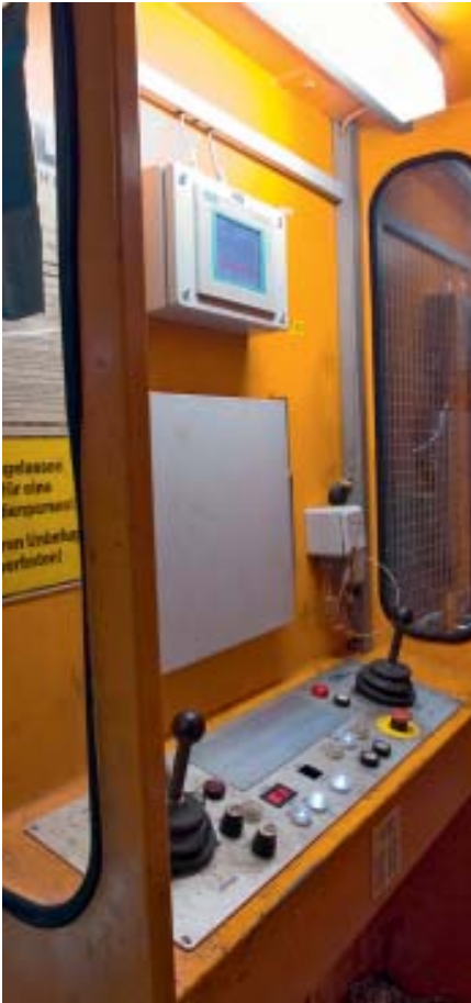
Über Profinet IO angebundene Touch Panels Simatic TP177B ermöglichen im RBG-Führerhaus den komfortablen Tippbetrieb
