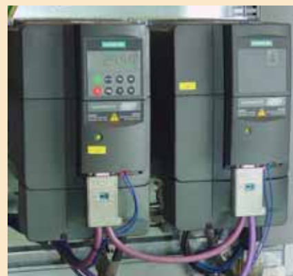
Bild 2: Die Drehzahlregelung der Getriebemotoren übernimmt der Frequenzumrichter Micromaster 440 mit Profibus-DP-Anbindung
