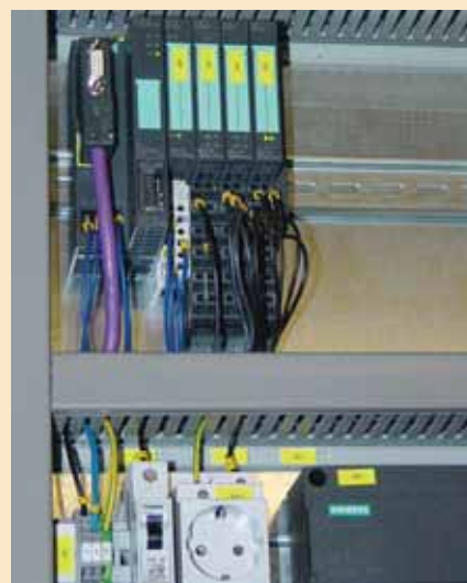
Bild 4: Über die dezentrale Peripherie ET200S lassen sich Sensordaten bündeln und über das Interface-Modul via Profibus an die Steuerung übertragen
