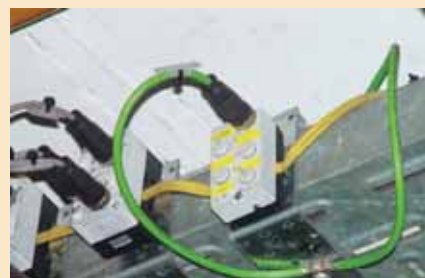
Bild 3: Die gesamte Sicherheitstechnik mit den 56 Not-Stopp-Tastern wurde über ASI-safe realisiert
