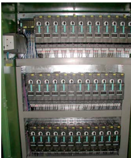
Schaltschrank mit ET-200S-Motorstartern, bestückt in platzsparender Aufbautechnik und mit durchgängiger Automatisierungstechnik in Totally Integrated Automation (TIA)
