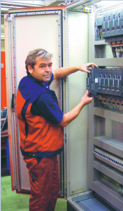
Der für die Anlage zuständige Betriebs- elektriker Reinhard Schulz demonstriert, wie sich die Motorstarter auf Grund der stehenden Verdrahtung unter Spannung austauschen lassen
