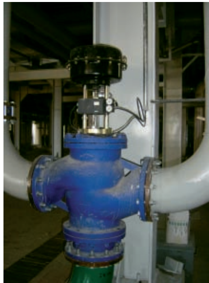
Abb. 3: Automatisiertes Drei-Wege-Regelventil mit Sipart-Positioner von Siemens
