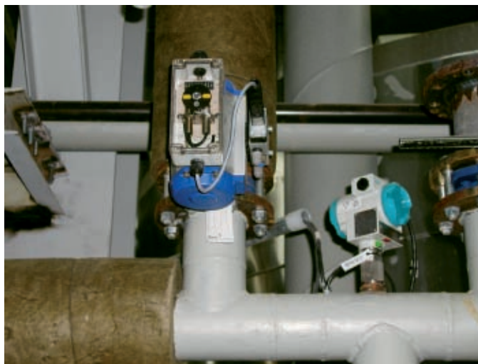
Abb. 2: Klappen und Messumformer – verbunden über Profibus-PA-Netzwerke zur direkten Kommunikation mit dem Leitsystem und dem Engineeringtool
