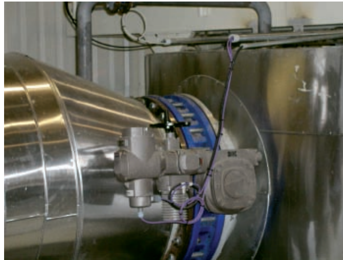
Abb. 4: Elektrisch angetriebene Klappe mit auma-Antrieb und direktem Profibus-Anschluss an Simocode MCC
