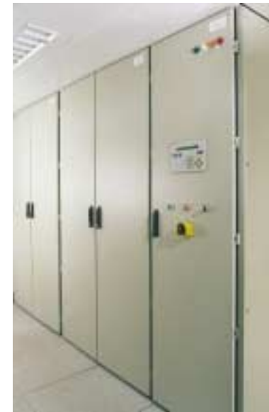
Simovert MV ist der erste Mittelspannungsumrichter mit HV-IGBT Leistungshalbleitern. Bei Bedarf – beispielsweise wenn Bremsenergie zurück in Netz gespeist wird – lässt er sich mit Active Front End auslegen
