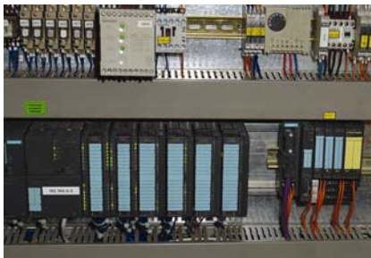
Abb. 2: Black-Channel-Prinzip heißt im Fachjargon, wenn eine fehlersichere CPU als PROFIBUS-Slave für sichere Signale die SPS lediglich als Datentransportplattform nutzt
