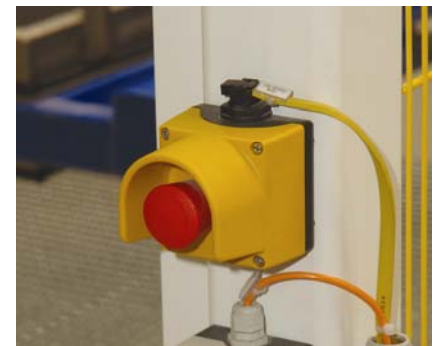
Abb. 2: Besonders platzsparend sind Sensoren und Aktoren, die bereits den AS-i-Knoten integriert haben; der Quittierknopf für den Bediener wird indes auf ein Feldmodul geführt
