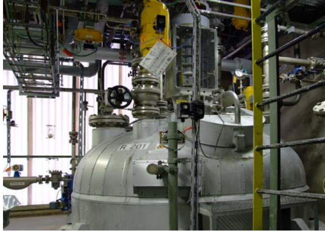
Abb. 2: Chemieanlagen stellen hohe Anforderungen an Sicherheit und Verfügbarkeit
