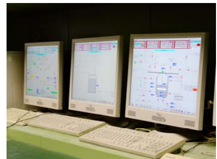
Abb. 4: Kiel Engineering, Siemens Solution Partner Automation, hat auch die drei eigenständigen Visualisierungssysteme in ein durchgängiges Client/Server-Konzept eingebunden
