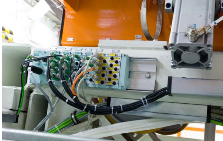
Abb. 3: Direkt im Prüfstand installierte dezentrale Peripherie ET 200pro
