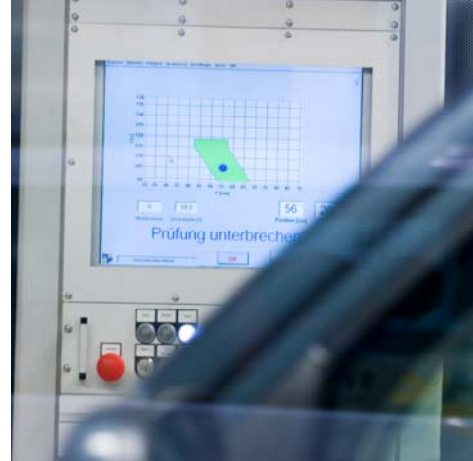
Abb. 4: Zur Visualisierung des Prüflaufs sowie für die Instandhaltung wurde eine Server-Client-Installation unter SIMATIC WinCC realisiert
