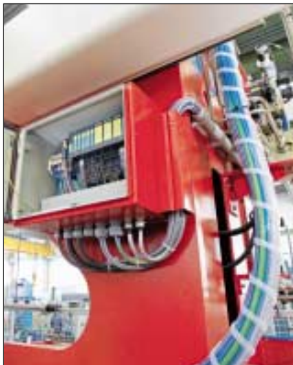
Über herkömmliche Profibuskabel und das Profisafe-Protokoll gelangen konventionelle und sicherheitsgerichtete Prozess-Signale von der dezentralen Peripherie ET 200S Profisafe zur fehlersicheren Steuerung Simatic S7-300F.
