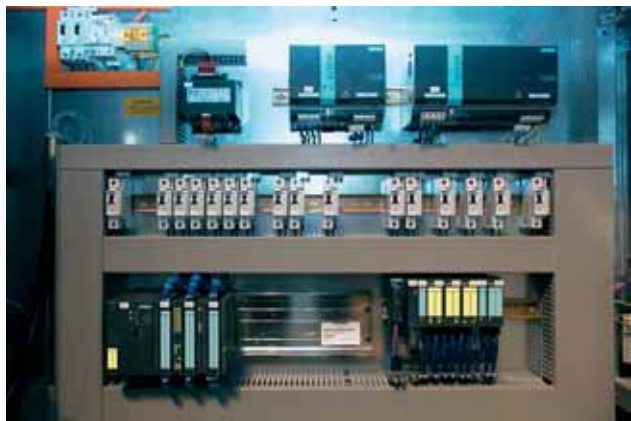
Bild 3: Übersichtlich und Platz sparend: eine Siemens Steuerung für Fehlersichere- und Standardfunktionalität
