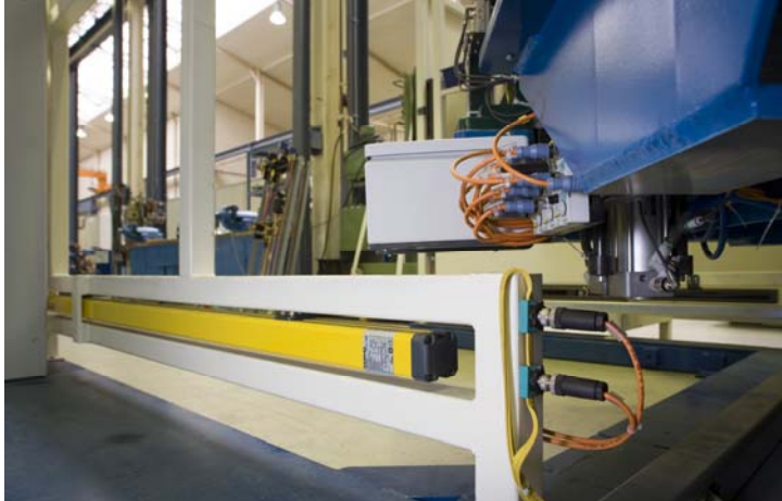
Abb. 1: Der horizontale Lichtvorhang sichert den Handarbeitsbereich vor dem Drehtisch, falls eine Eintrittsschutzverletzung des vertikalen Lichtgitters irrtümlich quittiert wurde (Hintertrittschutz)
